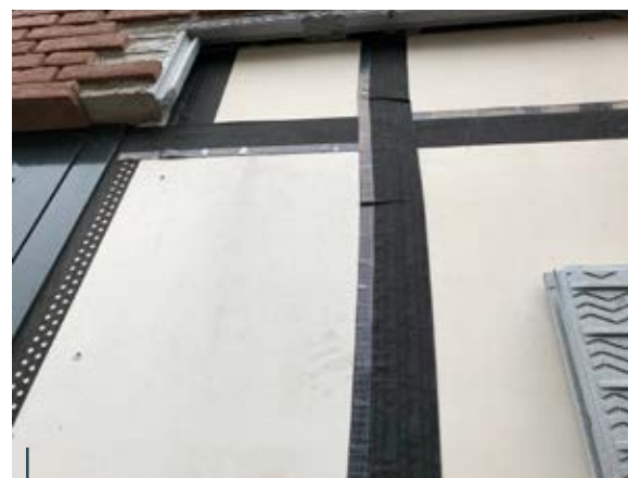
Colmatage des jointures
